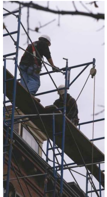
Bauarbeiter. Ist die Freude, für andere ein Haus bauen zu dürfen, ihre Motivation? Oder motiviert sie der Lohn am Monatsende? FOTO: LDS
